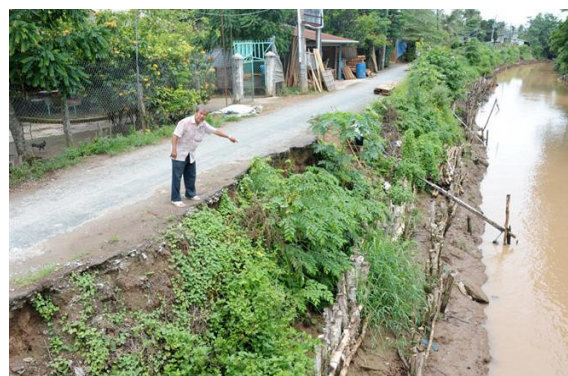
Sạt lở con đường nhựa ấp Long Thuận 2, xã Long Điền A
